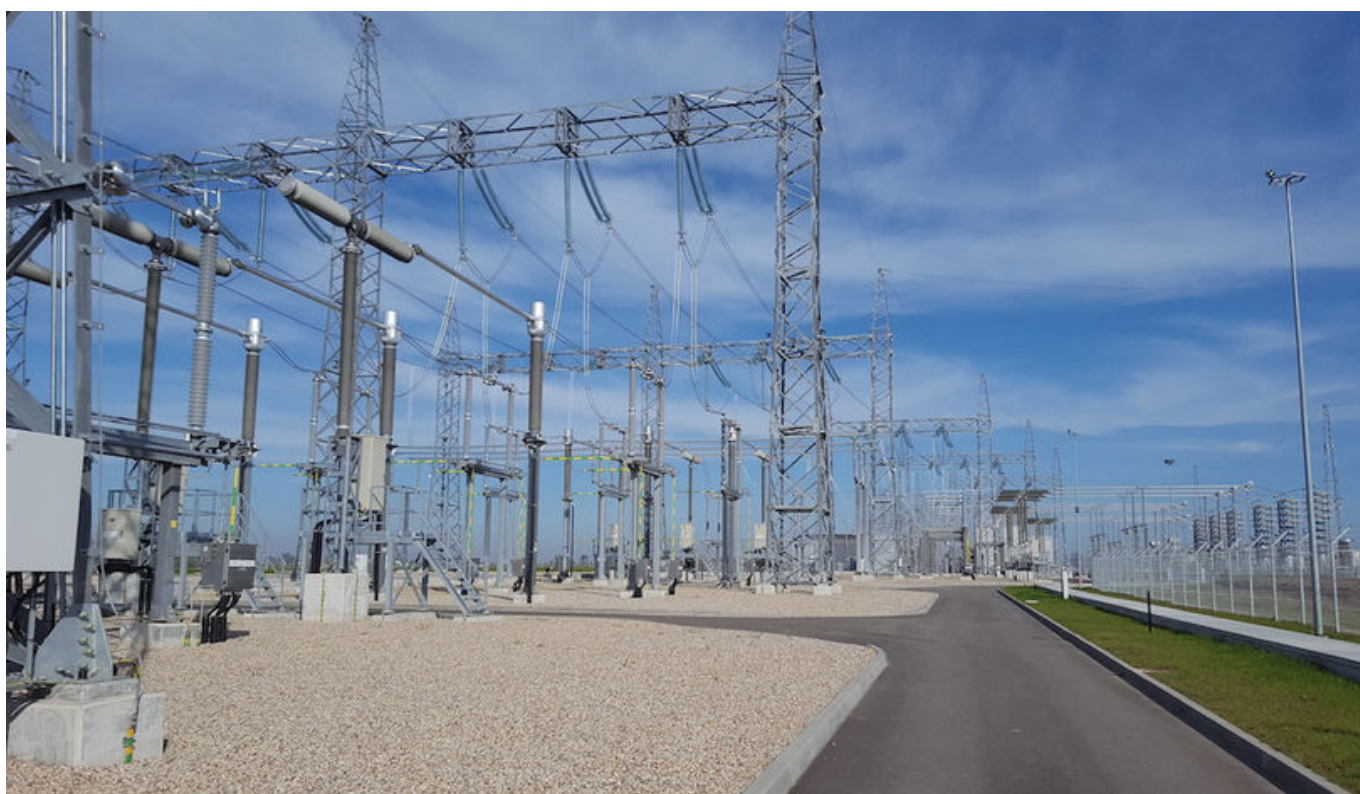
Stacja LitPol Link w Olicie. Fot. Energetyka24.com
