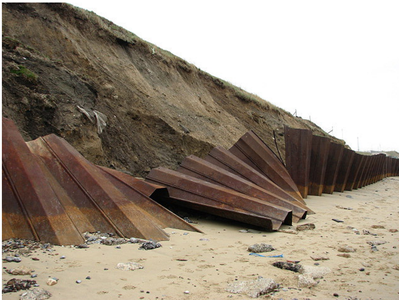
Stalowe umocnienia klifu zniszczone przez działanie fal morskich; geograph.org.uk
